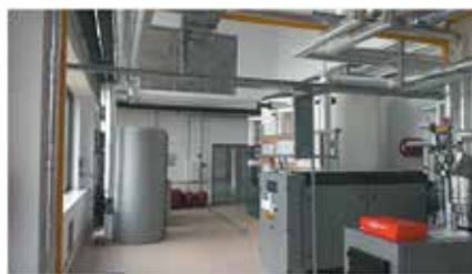
Fot. 3. Fragment węzła ciepłno-chłodniczego w Laboratorium Wytwarzania Energii CBZiE.
