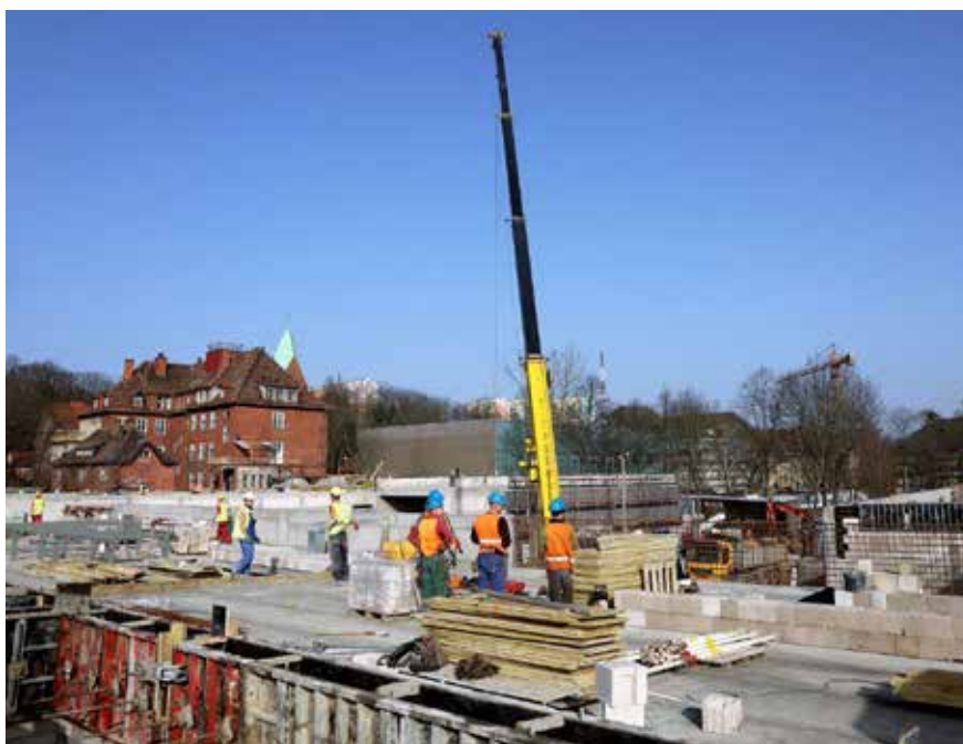
Budowa Centrum Edukacji Zawodowej i Biznesu przy ul. Warszawskiej w Gorzowie (fot./źródło: UM Gorzów)
