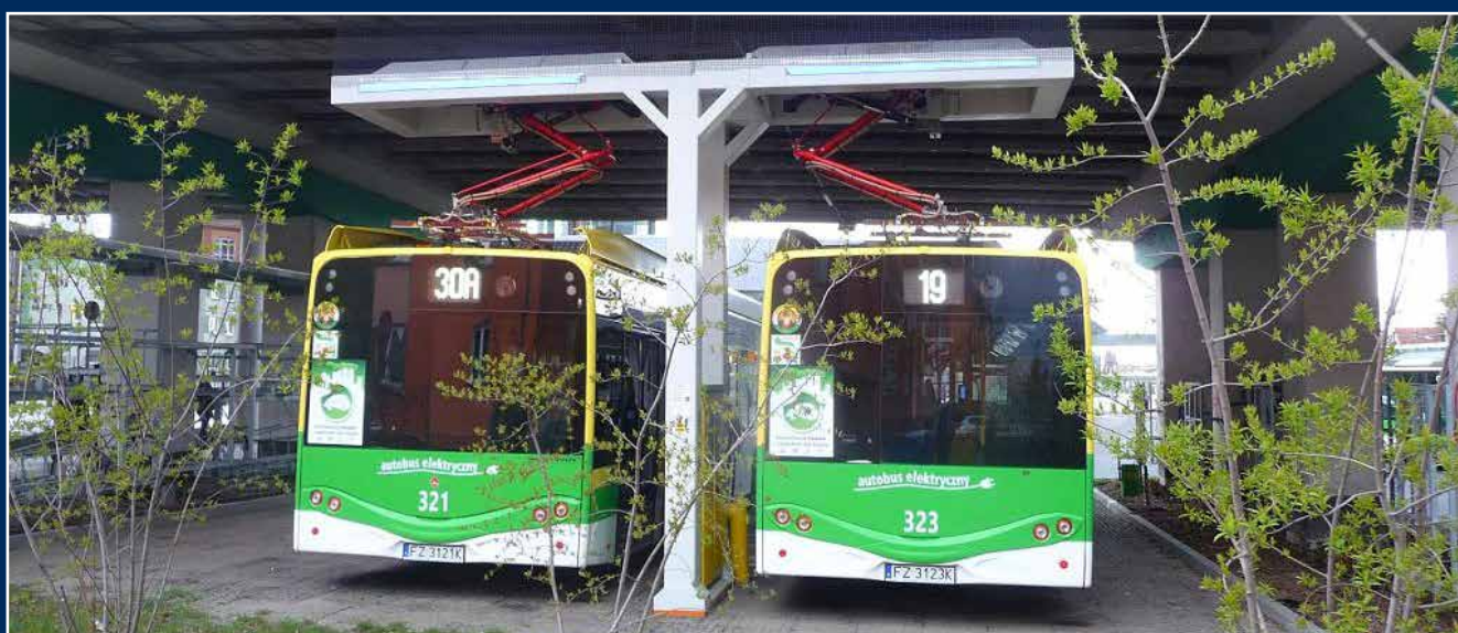
Tak są ustawione autobusy w czasie ładowania akumulatorów. Kierowca precyzyjnie podjeżdża na stanowisko, w czym pomagają odbojniki zamontowane na części jezdnej stanowiska, po ustawieniu się pojazdu opuszczany jest pantograf i rozpoczyna się cykl ładowania.
