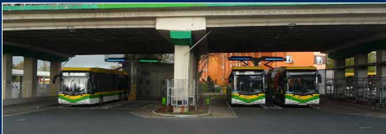
Cztery stanowiska ładowania autobusów (w chwili robienia zdjęcia trzy z nich były zajęte przez ładujące się autobusy) wybudowane przy Centrum Przesiadkowym (przedstawionym w numerze 3/2018 naszego numeru dostępnym na stronie internetowej naszej Izby) w pobliżu dworca PKP w Zielonej Górze. Wydajność stacji ładowania pozwala na jednoczesne ładowanie do czterech autobusów. Centrum Przesiadkowe jest miejscem, gdzie zaczyna się lub kończy wiele linii komunikacyjnych, więc rzadko zdarza się, aby stanowiska nie były zajęte.
