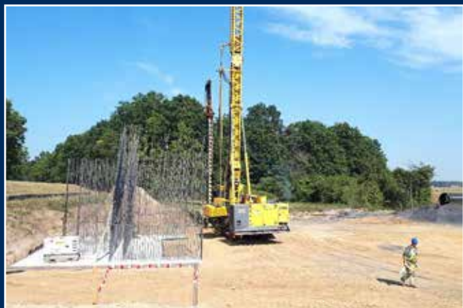
Kolumny KSS zastosowano bezpośrednio przy przyczółku mostu na Odrze od strony m. Bojadła
