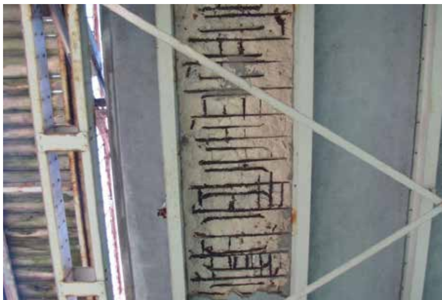
Ubytki betonu od spodu płyty pomostowej
