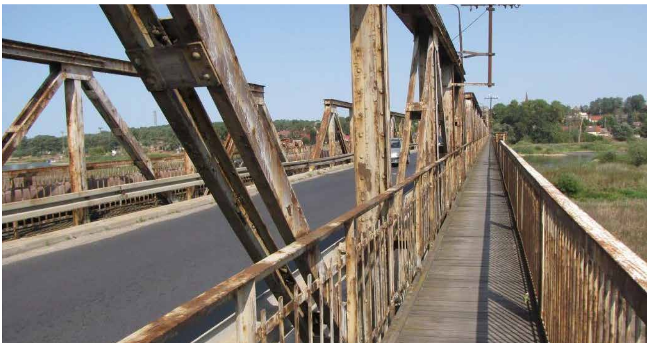
Widok na część chodnikową w przęśle „krótkim”. Widoczna korozja powierzchniowa kratownicy oraz balustrad
