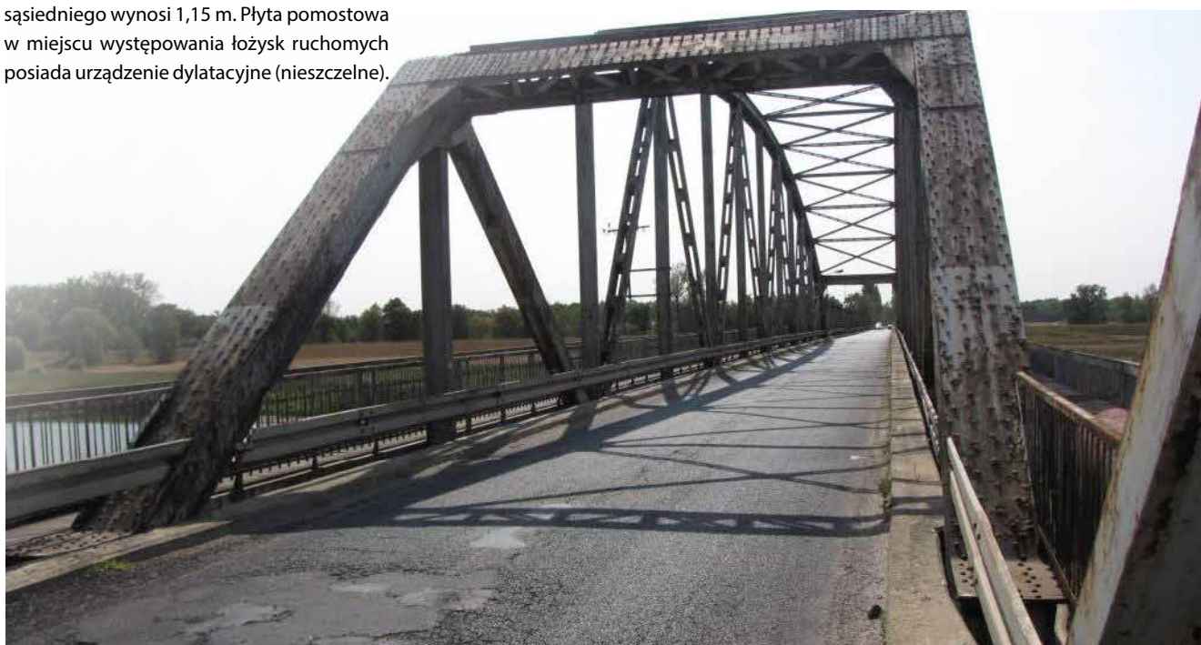
Widok na bramę portalową oraz pomost od góry. Widoczna korozja powierzchni stalowych, widoczne uszkodzenia jezdni
