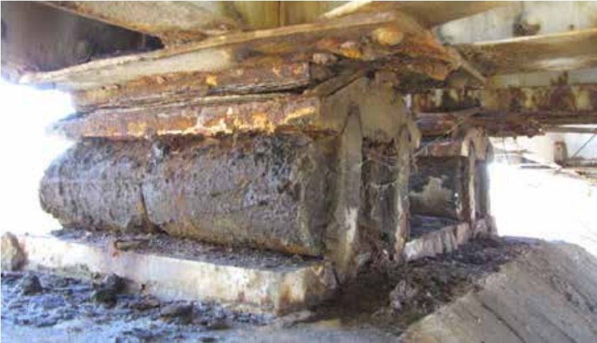
Widoczna zaawansowana korozja oraz zanieczyszczenia na łożysku
