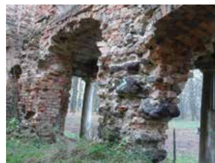
Ubytki filara w ścianie zewnętrznej od strony parku. STAN: LISTOPAD 2015
