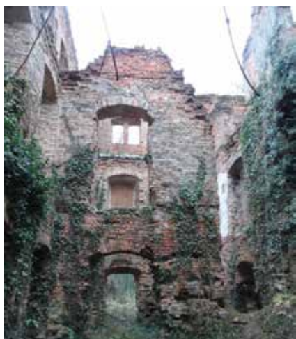
Widok ściany wewnętrznej pomiędzy pom. 2 i 3. Widoczna szczelina szerokości 1,78 cm na całej wysokości murów pomiędzy ścianą podłużną i poprzeczną. STAN: LISTOPAD 2015
