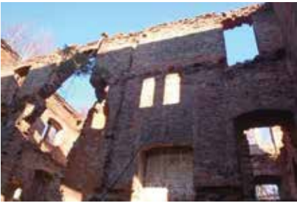
Stan techniczny ściany poprzecznej (pom. 6). STAN: LISTOPAD 2015
