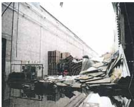
Rys. 1. Zawalony dach obiektu magazynowego
